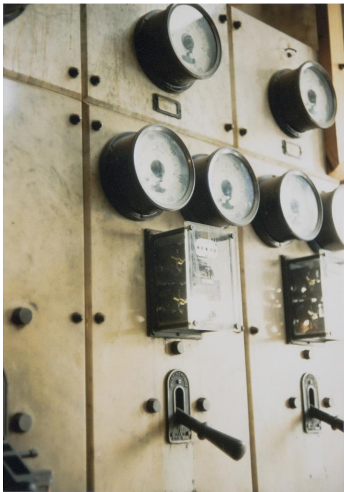
Detalle de los tableros de energía eléctrica ubicados en la sub-estación Puerto Galván.
